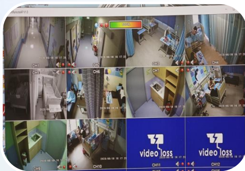
全區監視系統，預防及遏止宵小
